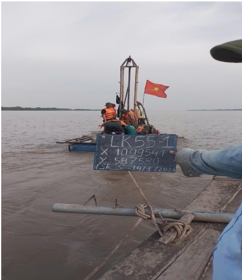
Ảnh: Khoan thăm dò khảo sát xây dựng đề án “Điều tra, đánh giá tiềm năng cát, cuội, sỏi lòng sông vùng Đồng bằng sông Cửu Long phục vụ phát triển bền vững kinh tế - xã hội”
